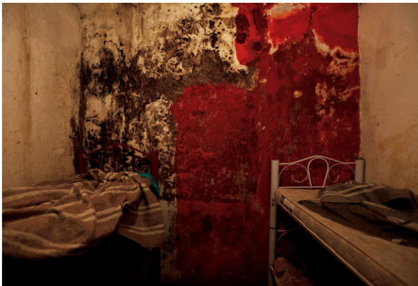
Figura 11. Foto de um cortiço do município de São Paulo da Rua Helvétia, novembro de 2009 apontando a ausência de janelas para ventilação. São Paulo, Brasil
